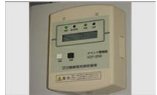
デマンド監視装置の導入
